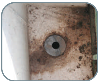
Figure 3 : Une plaque à orifice d'un diamètre approprié est placée derrière la grille afin de contrôler le flux
