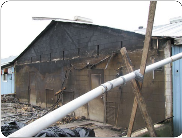
Figure 7. Exemple d'une séparation coupe-feu demeurée intacte qui a été efficace et a empêché les flammes de se propager à travers le bâtiment d'élevage. Source : R. Drysdale, Farm Mutual Reinsurance Plan.
