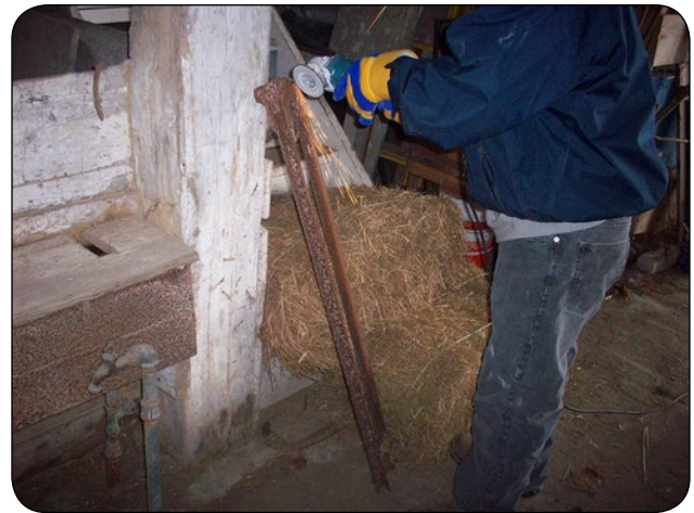
Figure 4. Meulage d'une tige en acier à proximité de matières inflammables.
