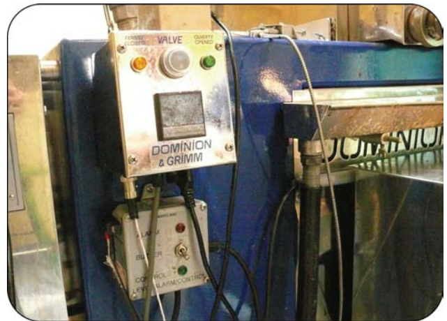
Figure 11. Boîte de commande ou alarme reliée au capteur et coupant automatiquement l'alimentation électrique du brûleur à mazout lorsque le niveau de sève dans la bassine à ondulations est trop bas.
