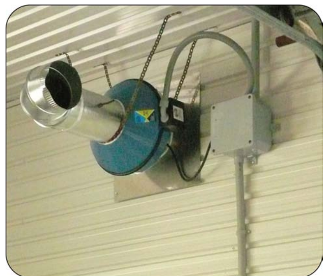
Figure 3. Ventilateur mural servant à introduire de l'air frais dans la pièce abritant l'évaporateur lorsque le pressostat du brûleur en commande la mise en marche.
