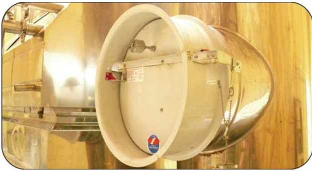
Figure 8. Clapet barométrique installé dans un tuyau de ventilation.
