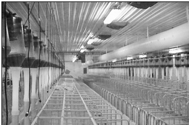
FIGURE 4. Tubes fluorescents de 4 pieds dans des luminaires étanches à la vapeur servant à l'éclairage d'un bâtiment pour truies gestantes.
